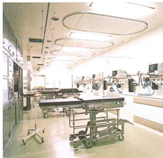
院内感染防止の手術室空調設備
