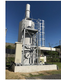
薬液洗浄式脱臭装置
