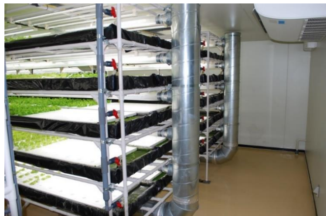
写真4. 空気循環用ビニールダクト方式
