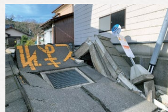
内灘町の液状化被害の例
